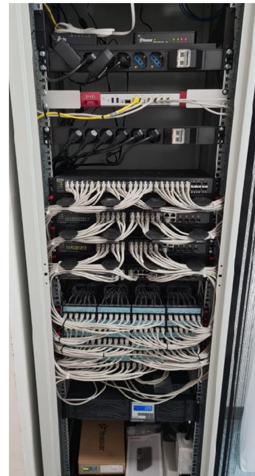
Impianto realizzato presso un call center di un grande gruppo nazionale
